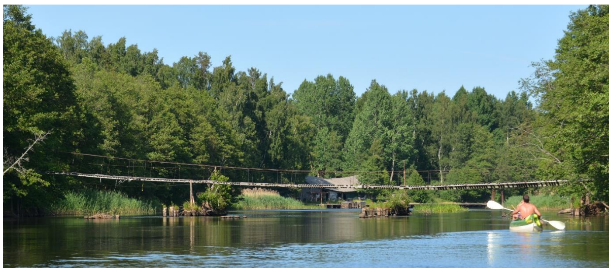
Tg-11. attēls. Avārijas stāvoklī esošais trošu tilts kājāmgājējiem un velobraucējiem pār Irbes upi pie Lielirbes bijušās dzelzceļa stacijas.
